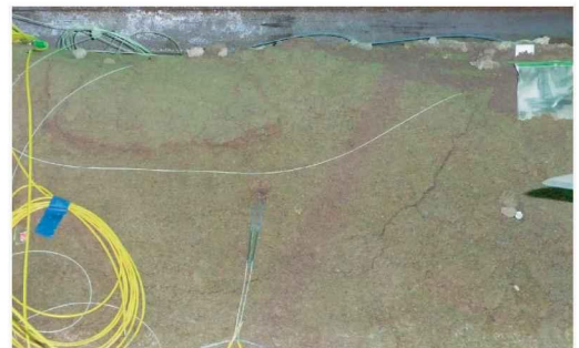
图7 边坡表面裂纹
